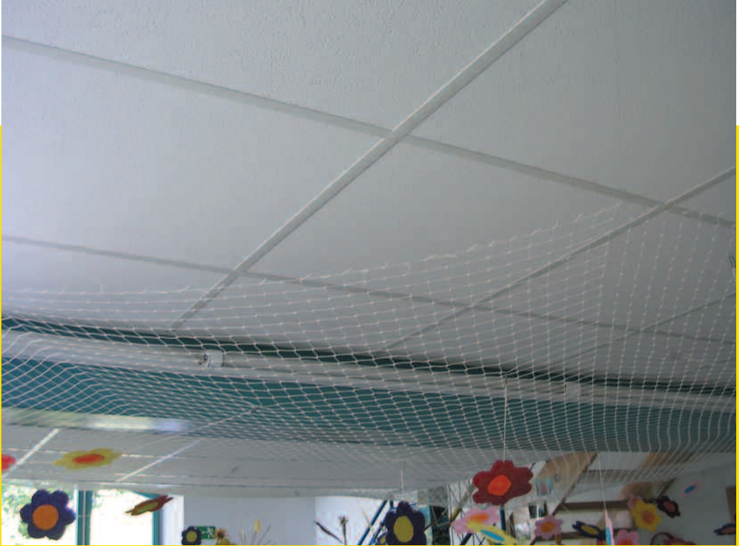
Schallabsorbierende Decke mit abgehängten Akustikplatten
